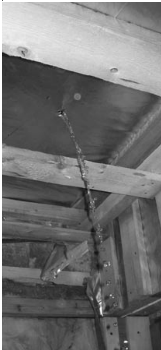
Yläkerran löylyhuoneen kattoon ilmestyi vesiputous kevyesti kattoa painamalla
