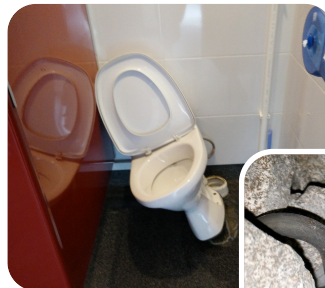
Öinen puhelinsoitto, kun vessanpönttö on irronnut lattiasta.
